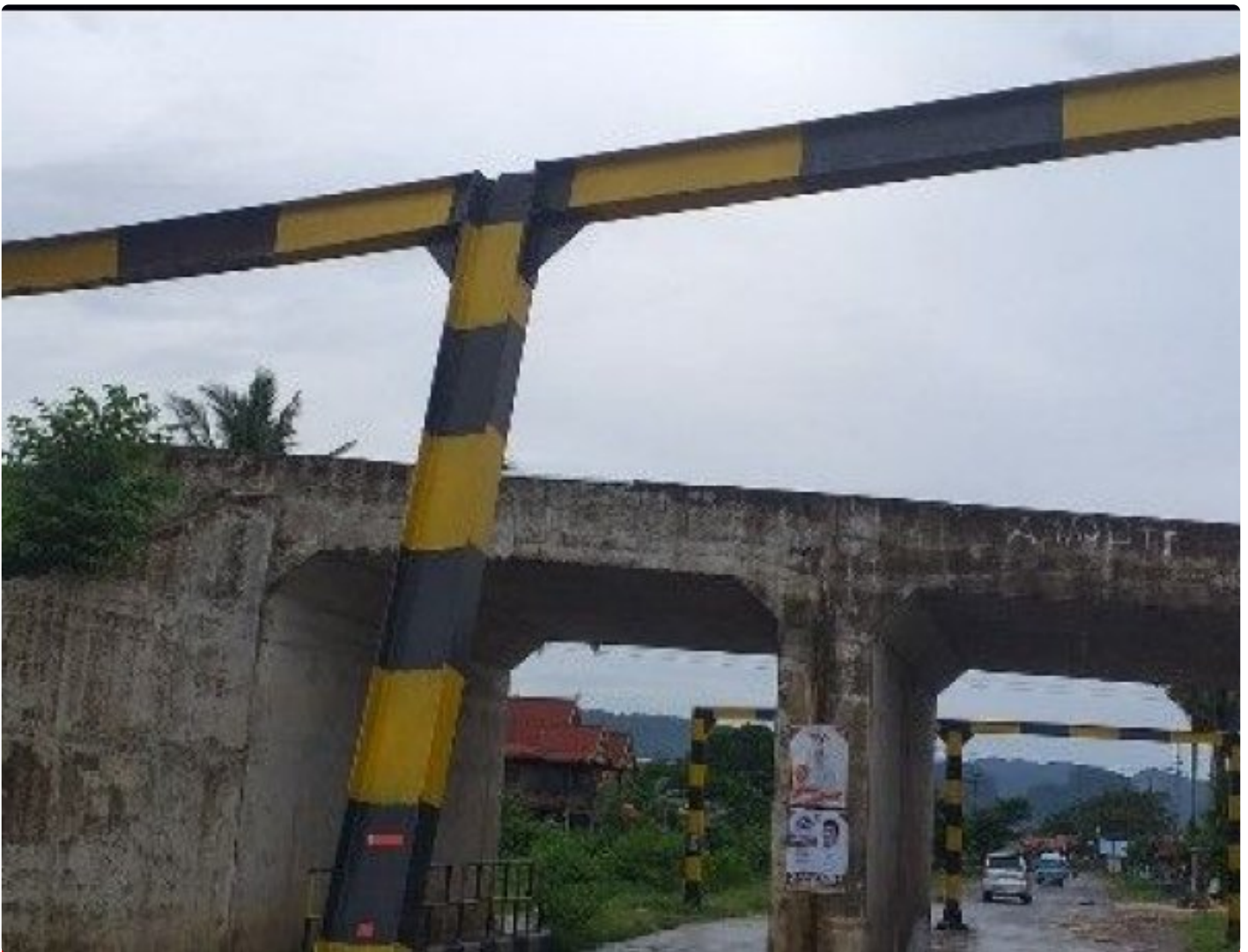
Pembatas Tiang Underpass Rel Kereta Api Jalan Tonasa Satu Soreang Baahayakan Pengguna Jalan
